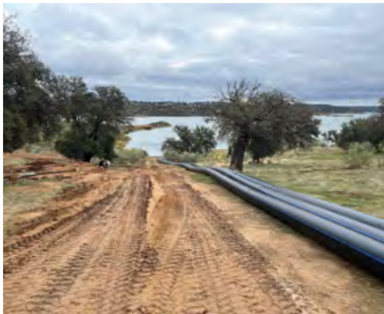
Tubos de canalización de las aguas de La Colada hacia el embalse de Sierra Boyera
